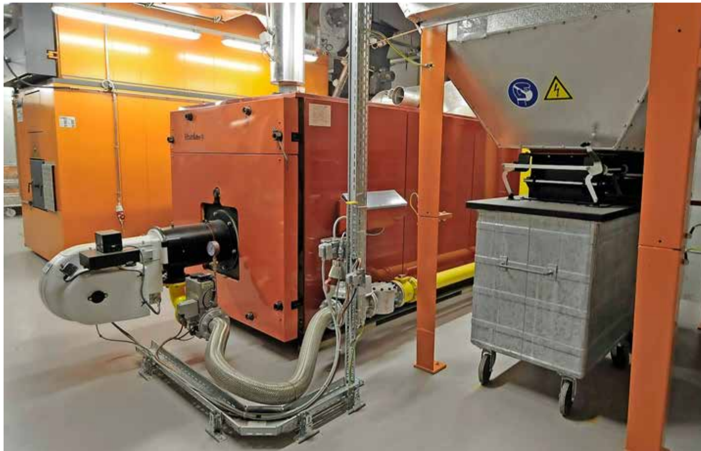
Ein wichtiges Steckenpferd von Groupe E: der Heizkessel der Fernwärmezentrale in Estavayer-le-Lac.
